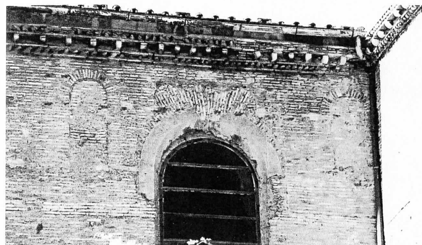
Figura 6. Roma, basilica di San Bartolomeo all'Isola, muro della navata al punto d'incontro con il campanile.
